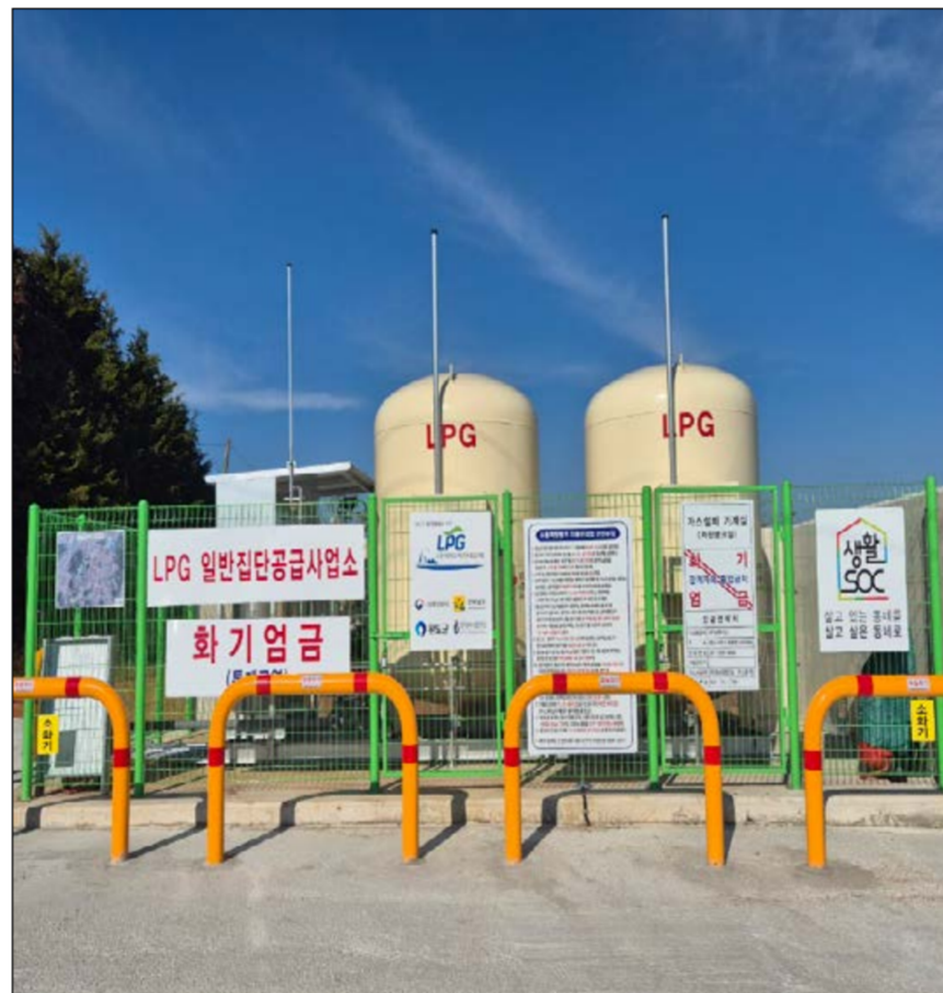
완도군 고금면 소재지에 구축된 LPG 저장 탱크 사진
